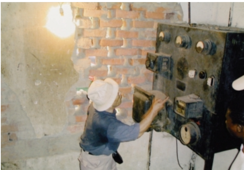
Matandani Mission 水力発電所計器盤 水力発電所の電気で 中央左上のランプが 点灯している。
