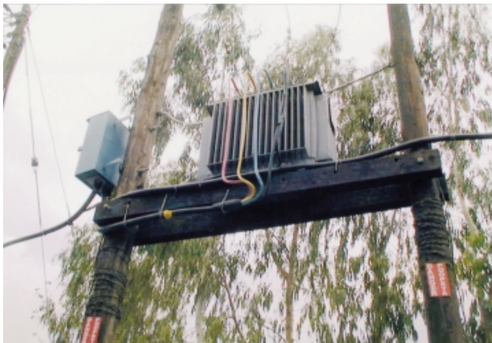
プランタイヤ郊外 マヤニ地区 電化プロジェクト 配電用変圧器
