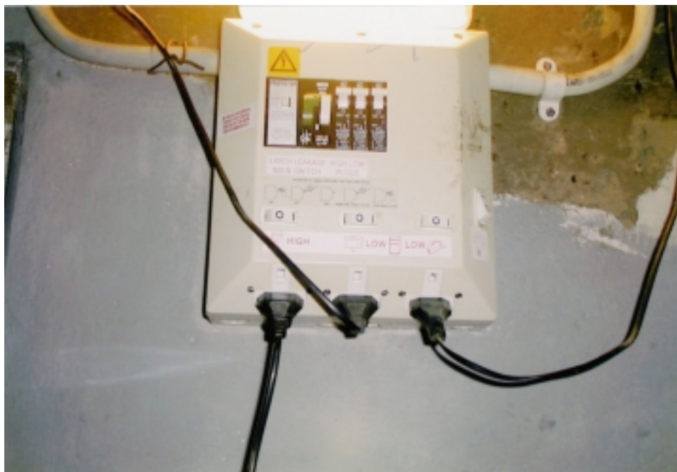
ブランタイヤ郊外 マヤニ地区 電化プロジェクト ready board 蛍光灯(上)と配電盤 左が10Aコンセント 右の2つが5Aコンセント
