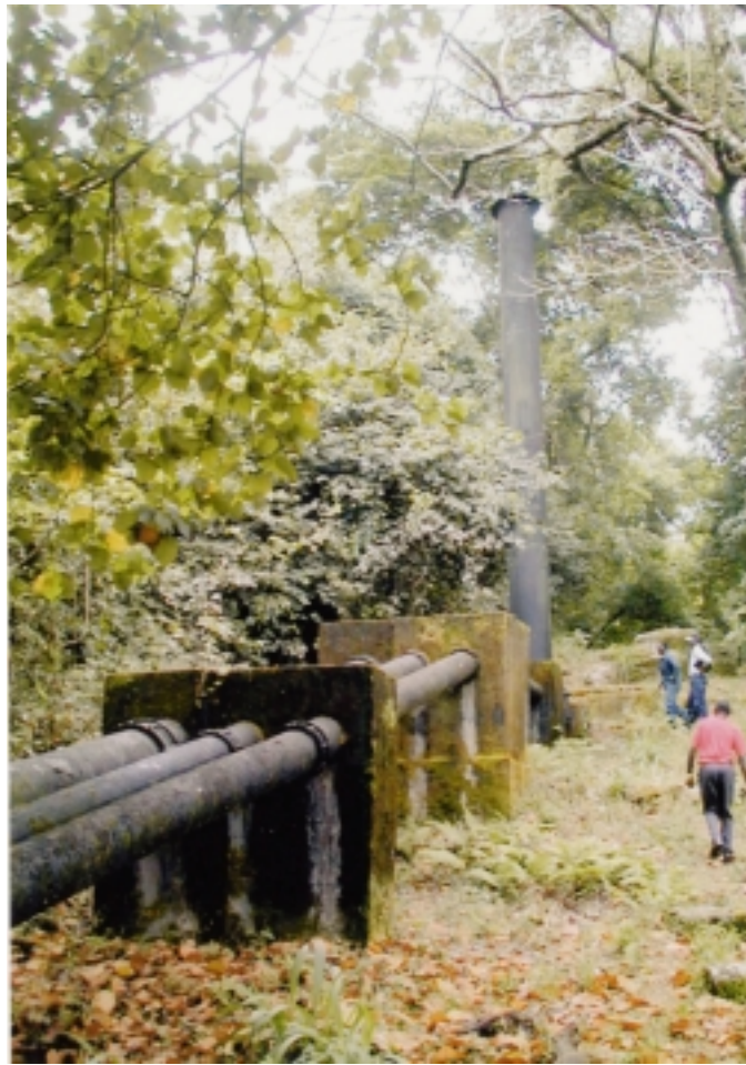
Lejeri Tea Estate, Ruo power station ペンストックとサージタンク
