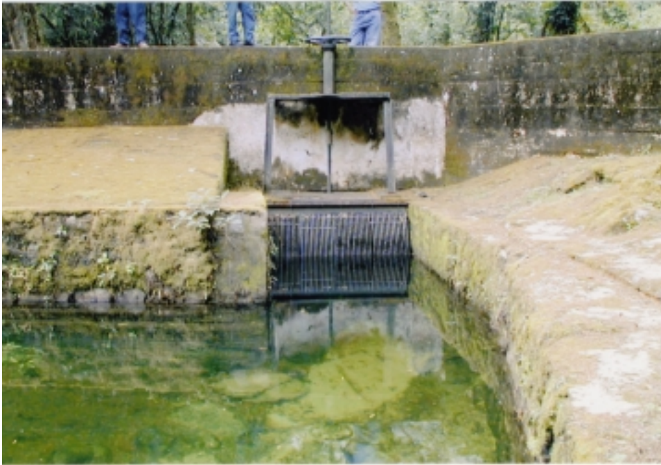
Lejeri Tea Estate, Ruo power station 取水口 スクリーンに落ち葉、ゴミがなく良く清掃されている。
