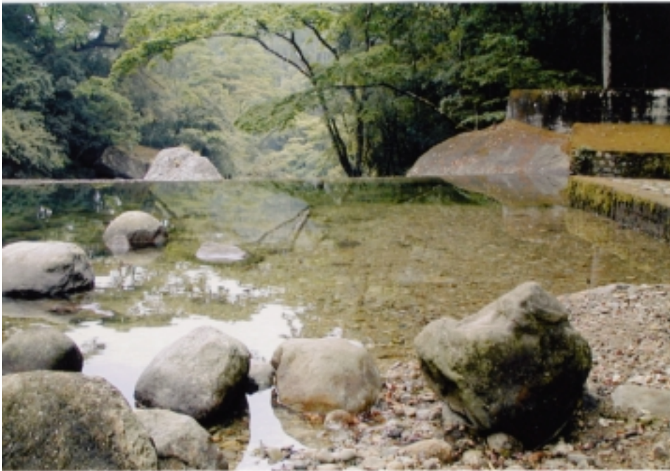
Lejeri Tea Estate, Ruo power station 取水ダム 流域の森林が保全されており、泥、砂の堆積が見られない。
