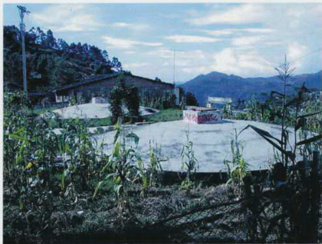
No.1 Catacocha Catacocha市内への配水している既存タンク 容量150m 3 ×2 現在1日1時間給水である。
