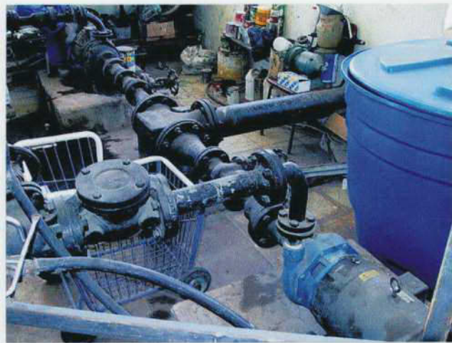
No.1 Catacocha 配水池への送水ポンプ このポンプの送水能力が少ないため、 水源水量を有効に利用しきれていない。
