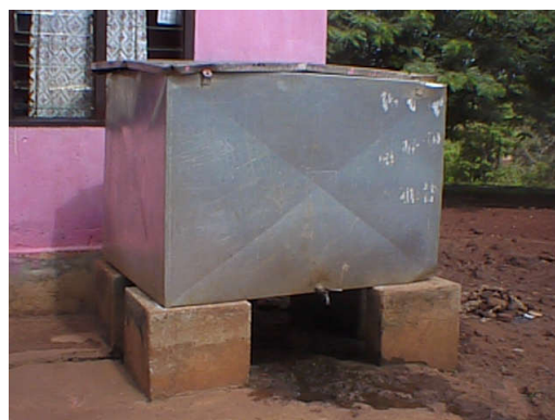
屋外貯水タンク
