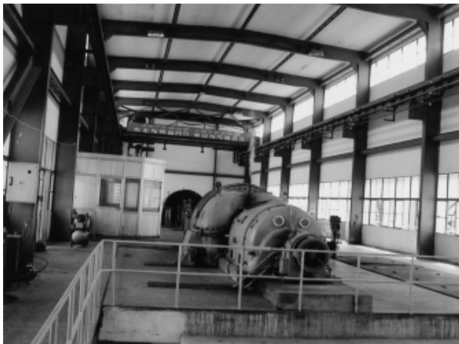
第2発電所 中国製蒸気タービン・発電機
