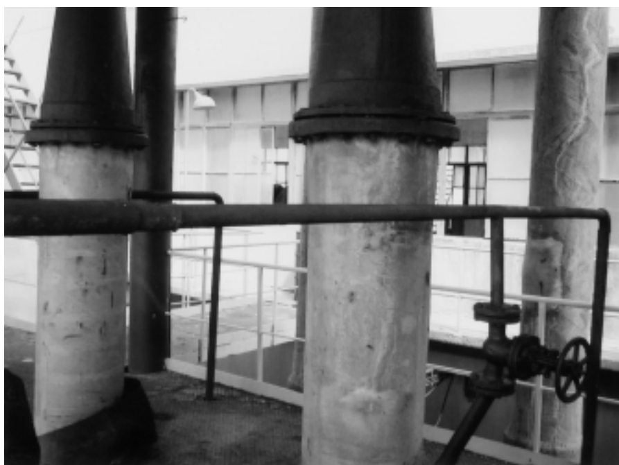
パイプの状況 (良く管理されている。)
