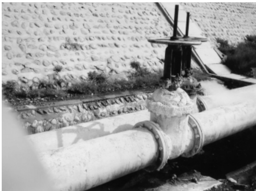
バルブに付着するスケールの状況
