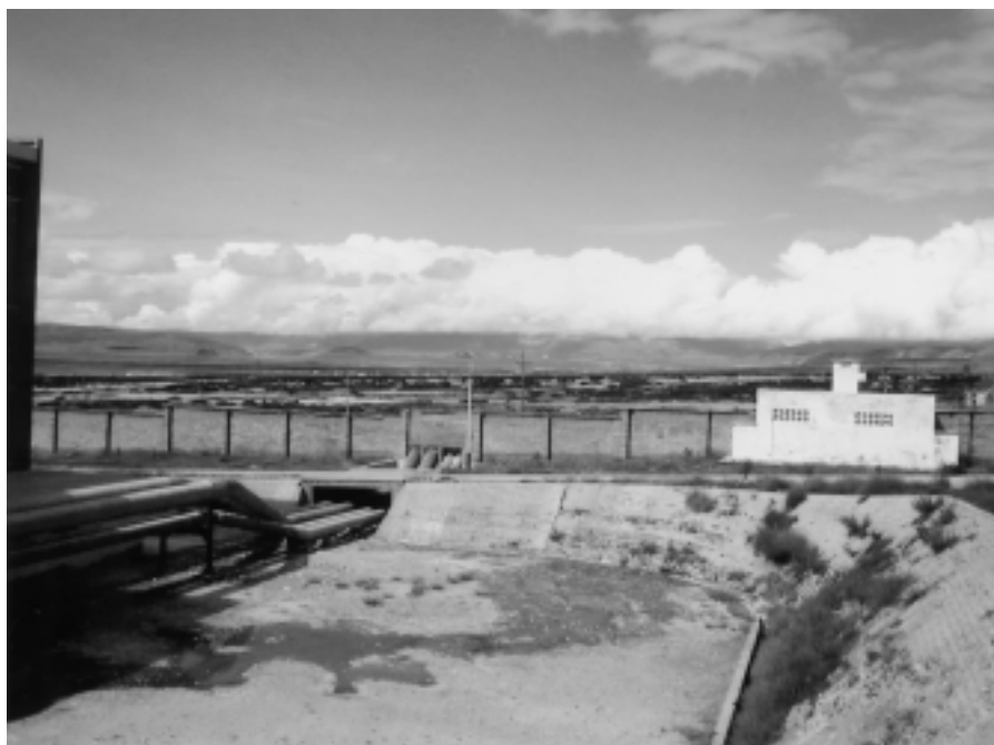
地熱フィールドから発電所までの 蒸気・熱水配管
