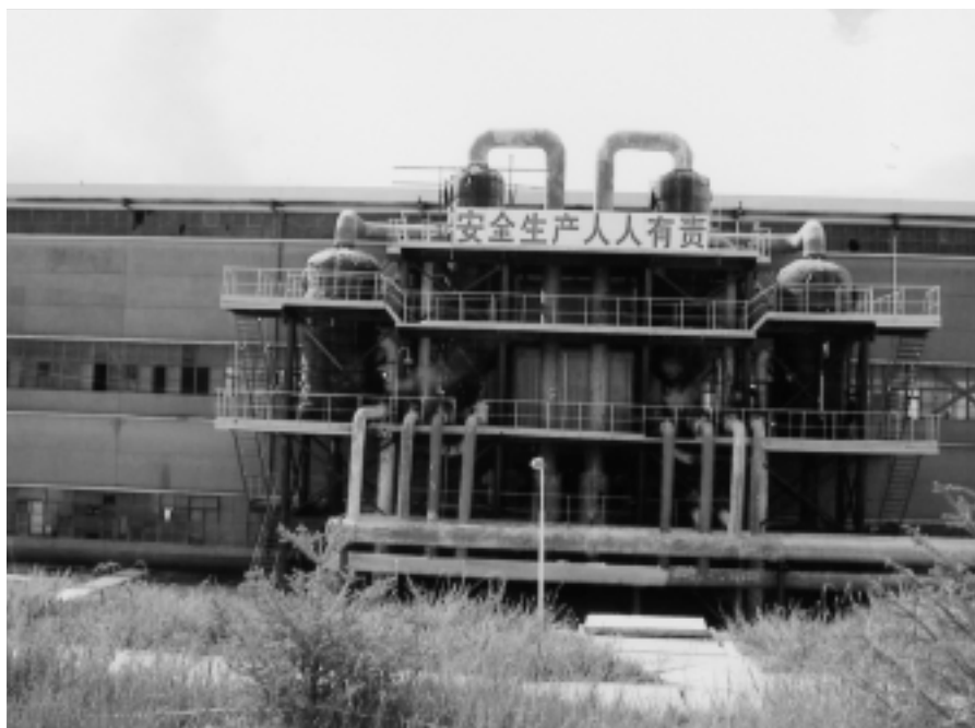
第2発電所フラッシャー
