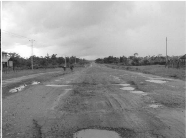
舗装表層剥離部
