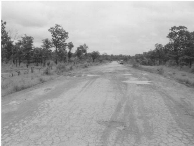
亀甲状クラック・ポットホール
