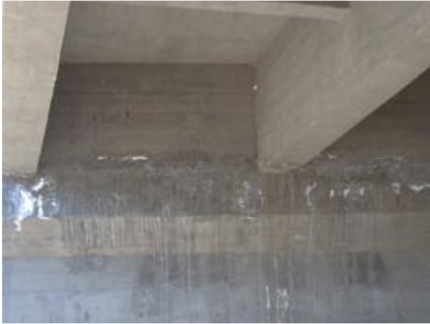
写真 - 2.4.3 橋梁部遊離石灰
