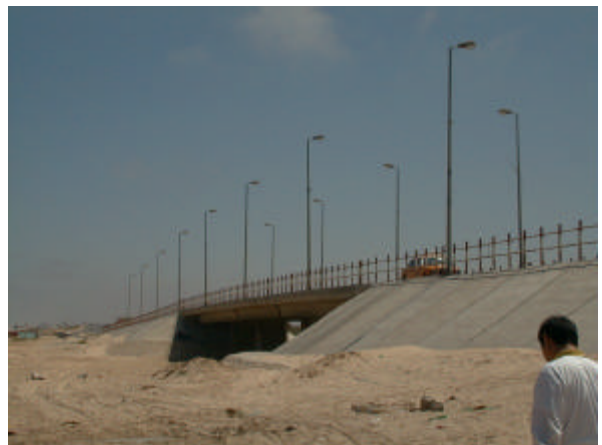
海岸道路にあるワディ・ガザ橋 (1995年完成だが、桁にクラックが見受けられる)
