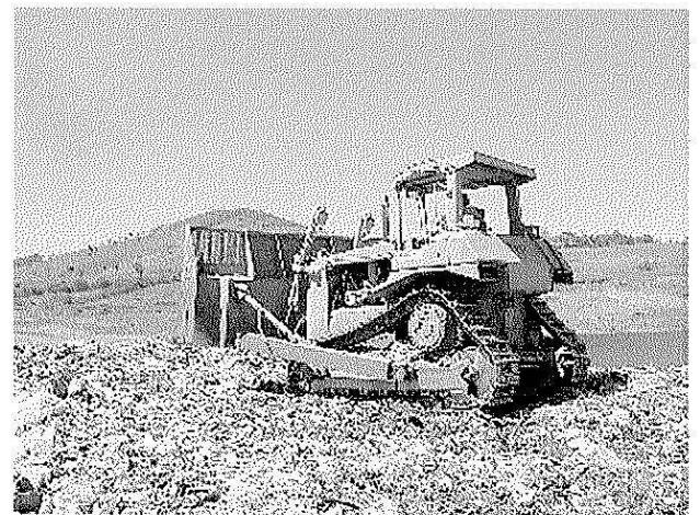
En el relleno sanitario de Nejapa los residuos son dispersados y compactados mediante motoniveladora (bulldozer).
