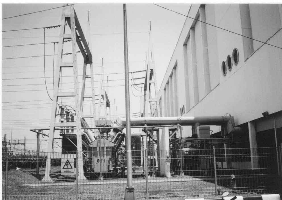
発電所～メインランス～屋外鉄構
