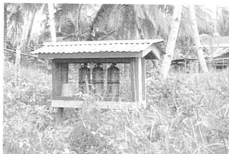
消火器スタンド
