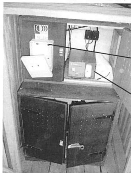
図5-9 Keranggas村家屋内部の設置状況
