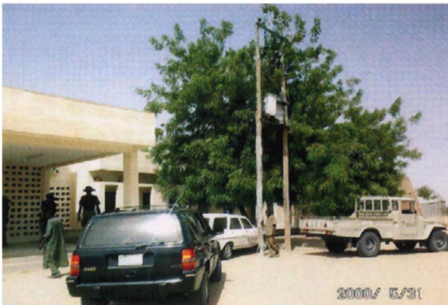
ダマサク町既設 11kV 配電設備
