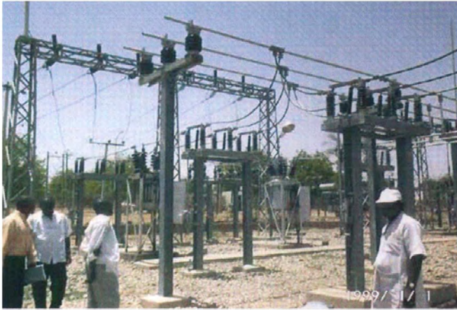
既設マイドゥーグリ変電所
