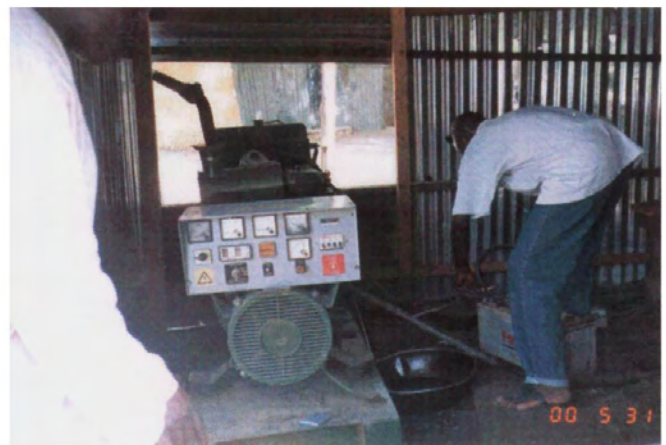
ダマサク町 給水ポンプ用家用発電機
