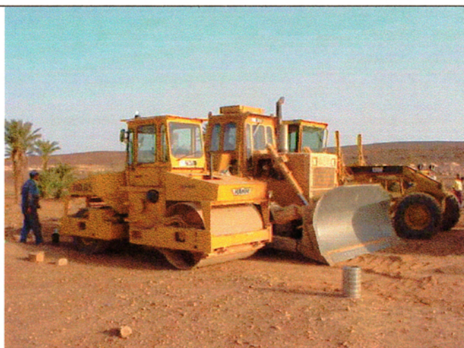
Ouarzazate 県内の工事現場で作業終了後駐機中の機材、ブリゲードで施工中
