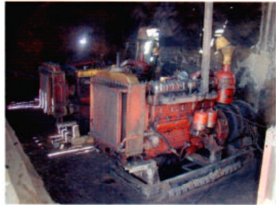
GOVI-ALTAI Buulin 村 ロシア製 60kw ディーゼル発電設備
