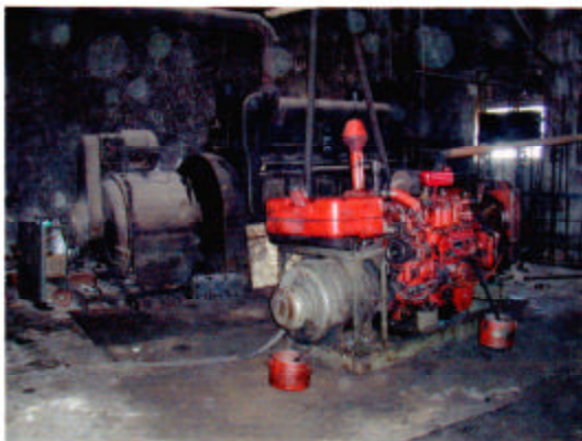
GOVI-ALTAI Sharga 村 ロシア製 60kw ディーゼル発電設備
