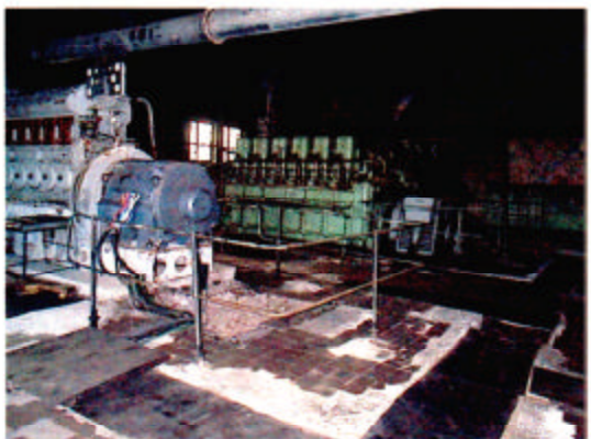
Zabkhan Tosontsengel 村 ロシア製 315kw ディーゼル発電設備
