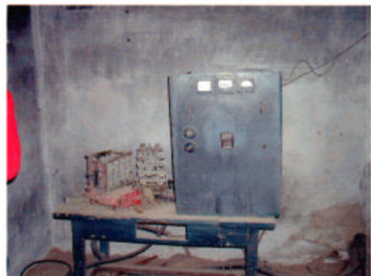
GOVI-ALTAI Bugat 村 ロシア製 配電盤
