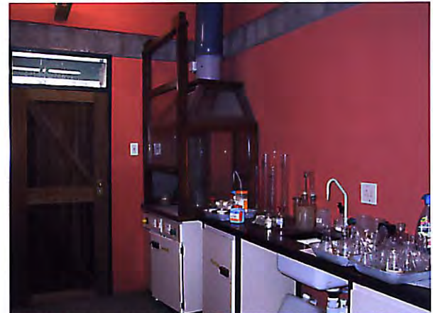
レソト高校、化学実験室と準備室との間に設置されたドラフトチャンバー。教室側から実験の様子を観察できるようになっており、この仕様は本件でも採用する計画としている。
