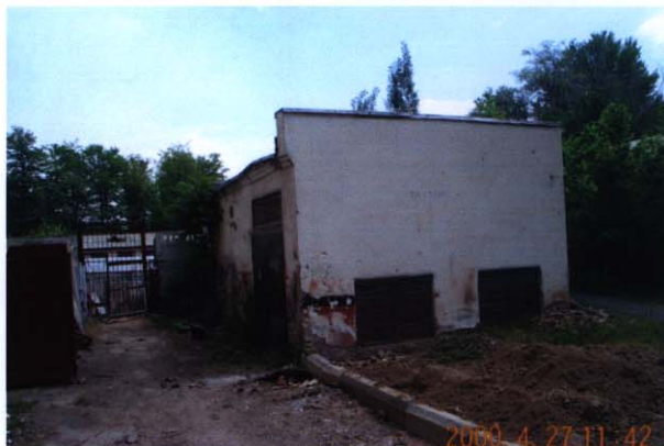
タシケント繊維軽工業大学 電源設備
