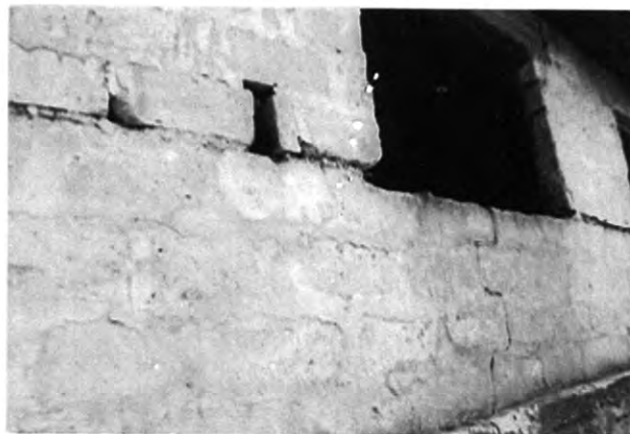
18. 無筋コンクリートブロック造の壁(Kinyerezi P.S.)
