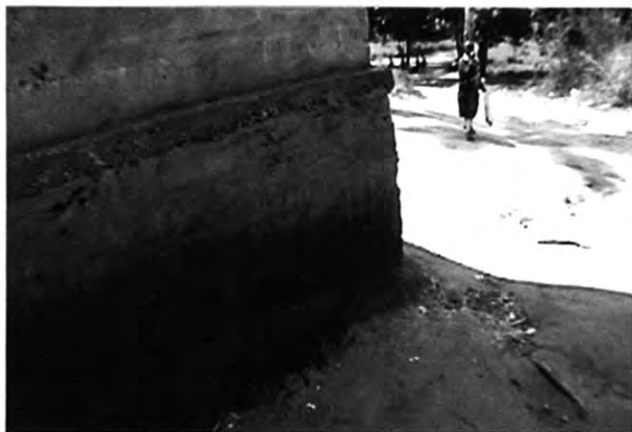
23. 基礎が露出している(Kinyerezi P.S.)
