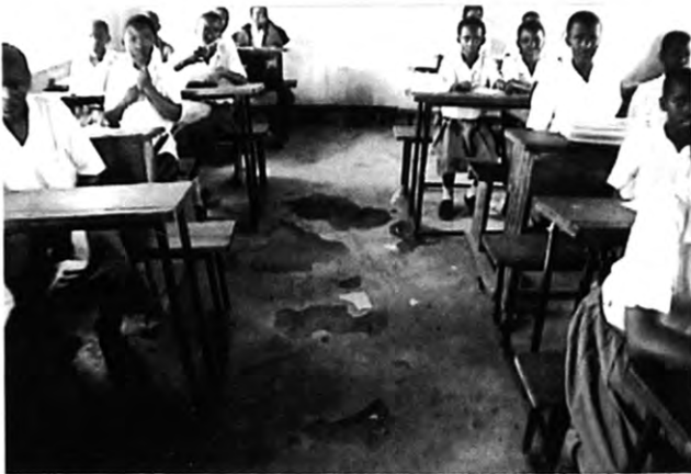
24. 床のコンクリートが欠けている(Kunduchi P.S.)
