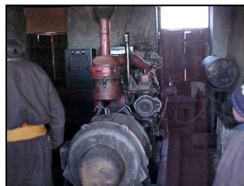
写真 I.7.4-2 スフバートル県オールバヤソム・センターのディーゼル発電機（ロシア製）
