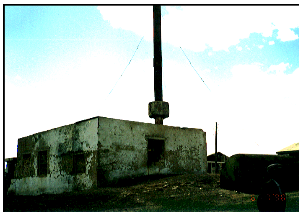
写真 I.7.9-1 集中暖房システムのボイラーハウス (スフバータル県ナラン・ソム・センター)
