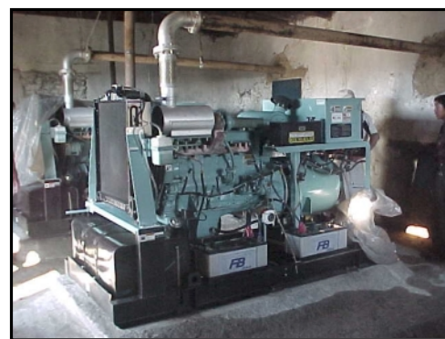
写真 I.7.4-3 ウモンゴビ県セルベイソム・センターに設置された日本製ディーゼル発電機
