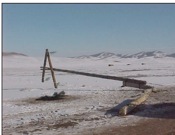
写真 I.5.3-1 交通事故で倒壊した 35 kV 送電柱
