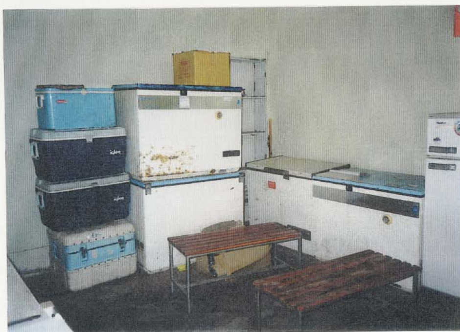
【MARDAN 県ワクチン倉庫】 コールドチェーン機材（一部故障）
