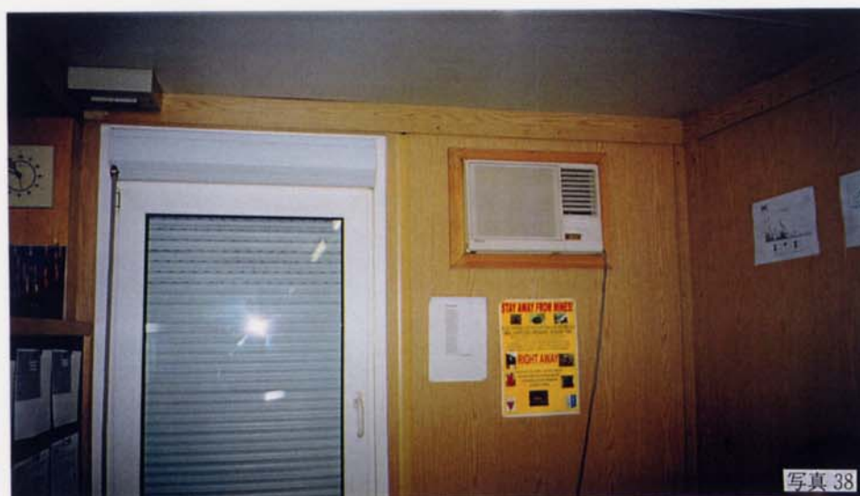
写真 38 BHMIC の空調装置：クーラーガスがぬけている為、冷気を 吐出できない。
