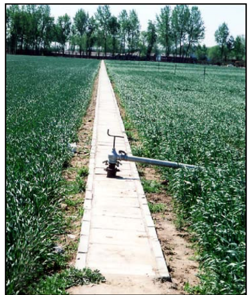
昌平実証普及基地圃場灌溉配管
