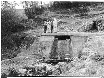
クトリムル湧水貯水タンク
