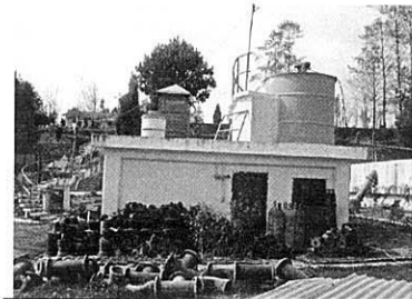
塩素消毒施設(屋上の丸いタンクが仮設消毒施設)
