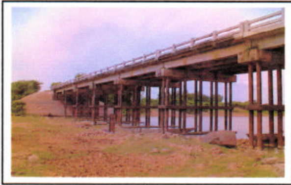
24号橋(首都ブノンペンより39k890m) 現況護岸、河床が洗掘された状況
