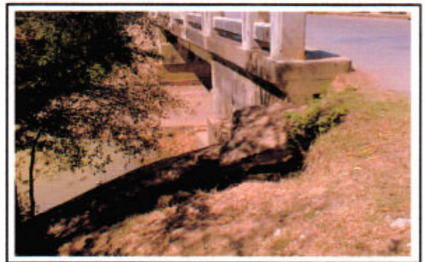
25号橋 取付盛土部が空洞化、崩壊した状況
