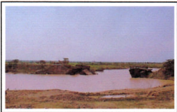
26号橋首都ブノンペンより41k210m) 過去幾度の洪水により現橋が沈下、損壊した状況
