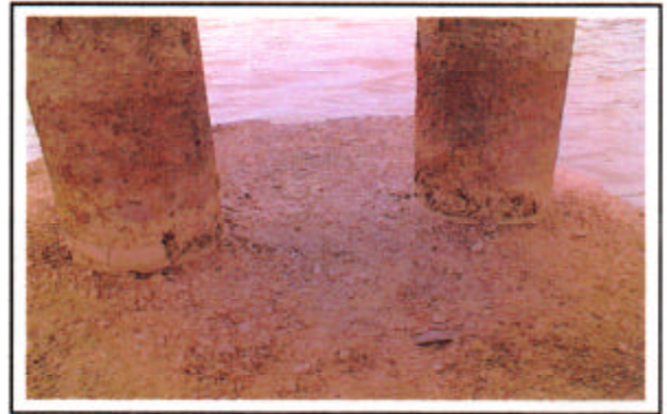
24号橋 橋脚鋼杭の腐食が極度に進行した状況(第5橋脚)
