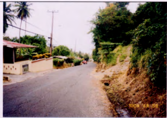
写真 62 (STA:19+800) 側溝が埋まっている
