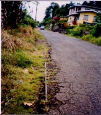
写真 59 (STA:18+600) 路肩部に露出した水道管
