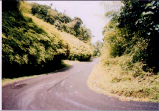
写真 25 (STA:7+600) オーバーハング状の切土 法面植生
