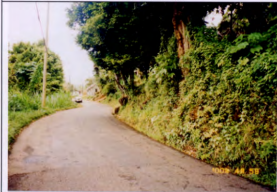
写真 43 (STA:13+350) 切土法面の保護が未整備 道路幅員 5.5m
