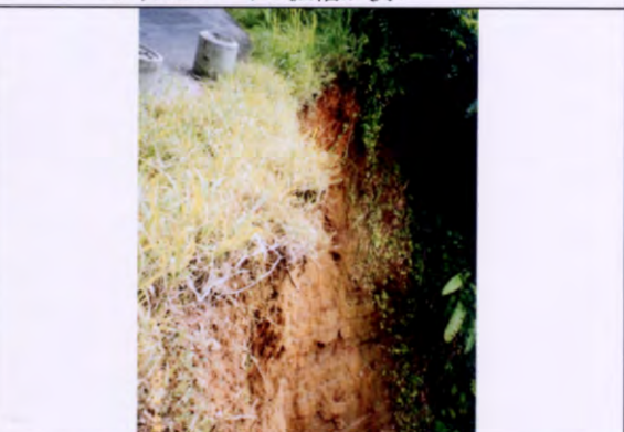
写真 46 (STA:14+800) 新しい河川側法面の崩壊
