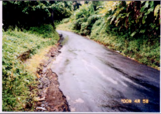
写真 18 (STA:5+600) 路肩の崩壊 道路勾配 10%
