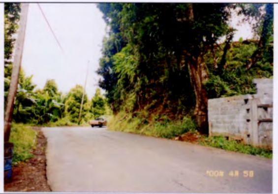
写真 42 (STA:13+300) カーブ部拡幅、切土法面 が未整備
