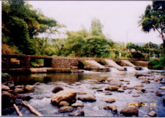
写真 57 (STA:18+050) St. Cyr Bridge 雨季にはたびたび水没する
