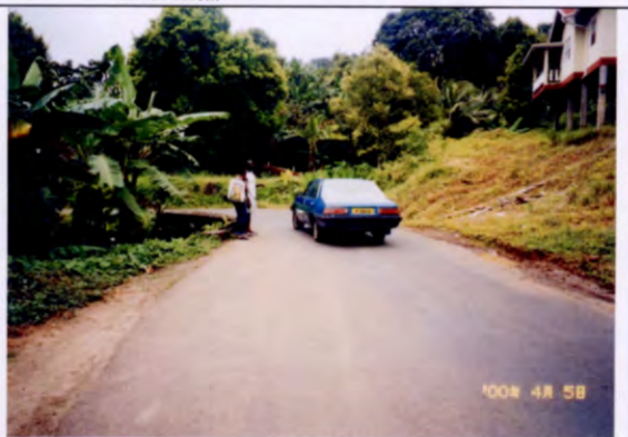
写真 44 (STA:13+920) 平面線形が極端に悪い ボックスカルバートの拡幅が狭い
