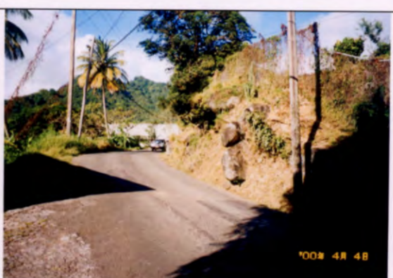
写真12 (STA:4+460) 右側切土法面に岩が露出
