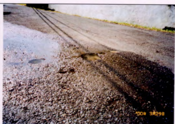
写真10 (STA:3+800) 水道管の破損による湧水
