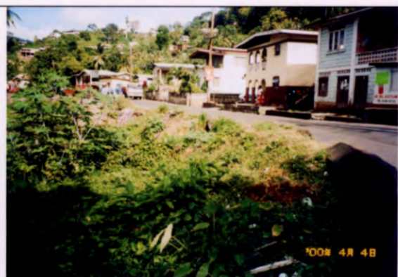
写真2 (STA:0-650) 河川法面が未整備
