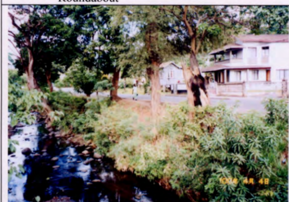
写真3 (STA:0-420) 河川法面が未整備
