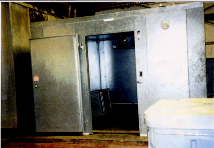
カナダ政府の協力によって導入された冷蔵庫（故障中）
