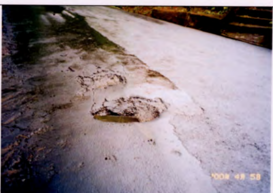
写真13 (STA:5+000) ポットホール
