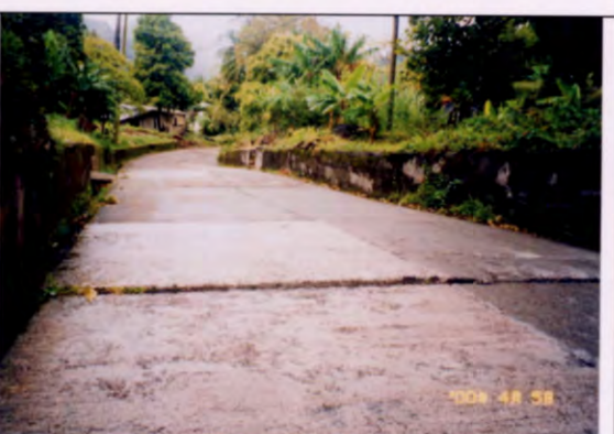
写真16 (STA:5+240) コンクリート舗装継ぎ目 に段差がある
