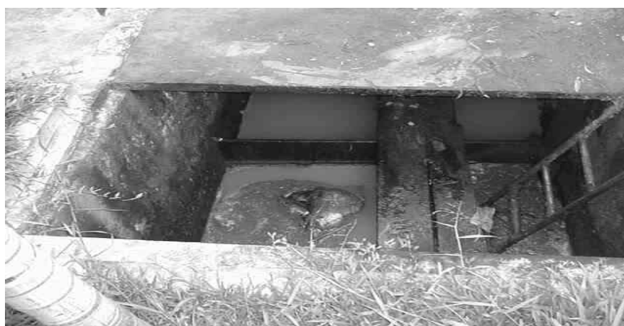
図 - 4 工場最終出口部のオイルセパレーター
