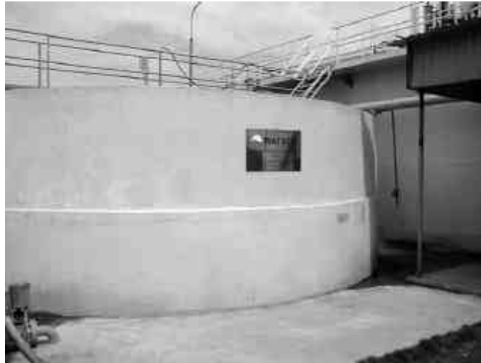
図 - 2 EPC により設計施工された排水処理設備
