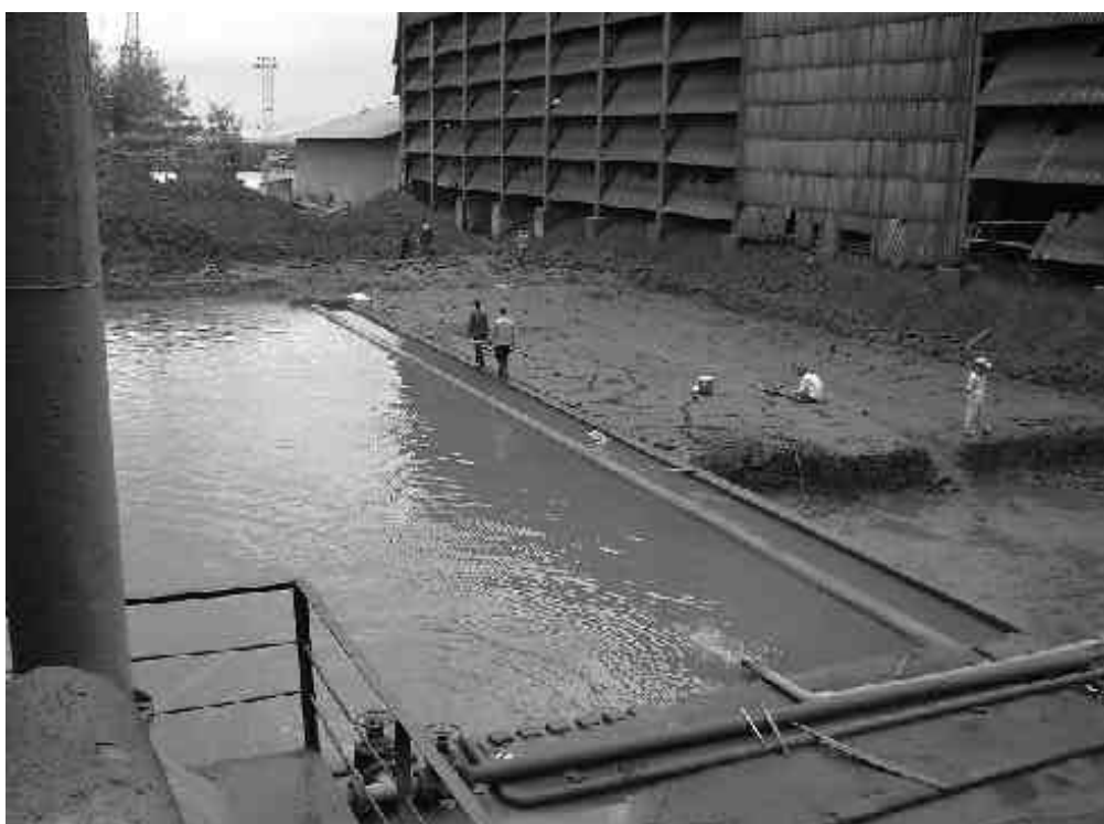
肥料工場 / 製造 (右後方) および原料回収工程 (沈殿池)
