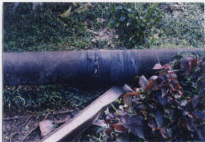
(6) 既存配水本管（老朽化が著しく、いたるところで、 ピンホールや修理箇所が確認される。）
