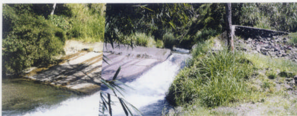
(11) Zakozoi 川既存取水堰（この河川には流量観測所が設置されておらず、流量観測も実施されていない。）
