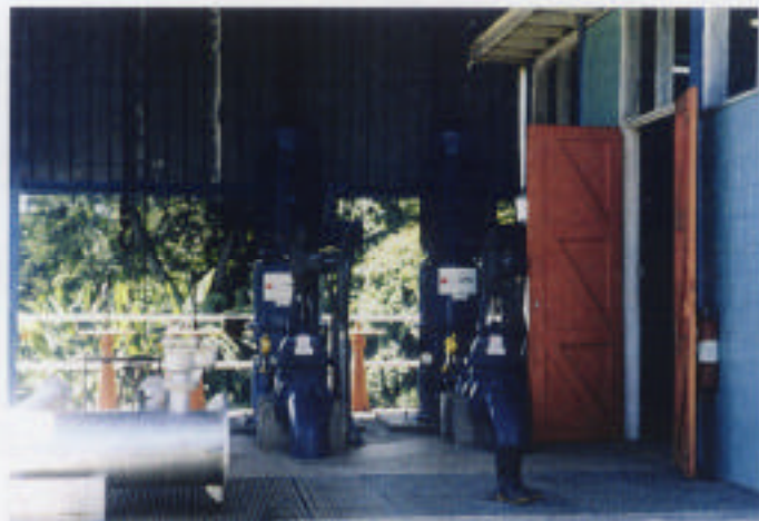
(28) 本邦の無償資金協力により調達された取水ポンプ
