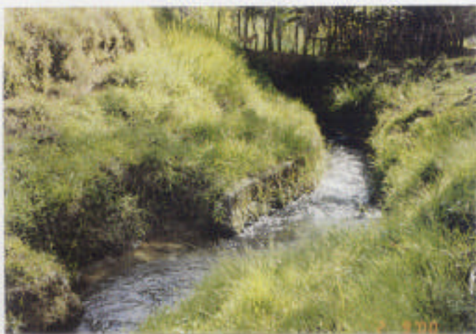
(12) 既存導水路（石積や斜面が崩壊している箇所がみられ、水路底に堆砂が確認される。）
