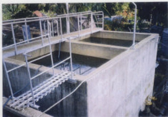
(17) 既存浄水場ろ過池（ろ過砂は目詰まりを起こしており、入れ替え時期に差し掛かっている。）
