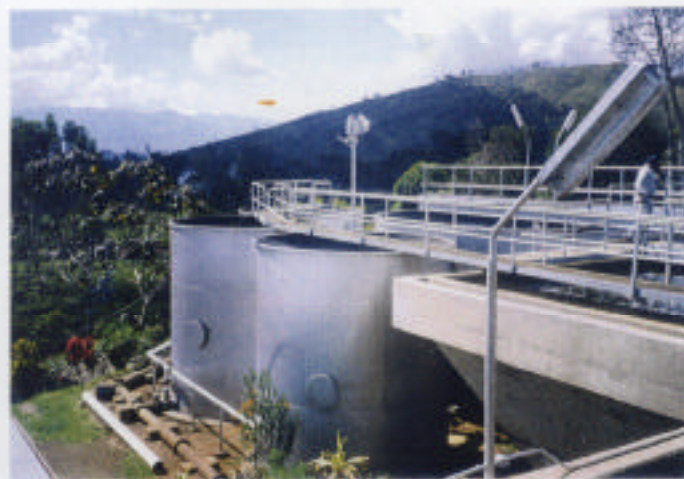
(16) 既存浄水場（2系統有しており、両系統とも稼動中。各系統の公称処理能力は不明であるが、規模から14,000 \text{m}^3 程度と推定される。）
