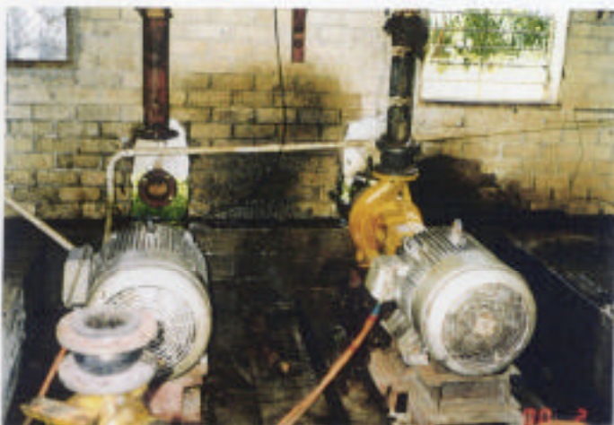
(3) 既存送水施設（1台予備のシステムになってい るが、老朽化により1台は故障しており使用できな い状況にある。）
