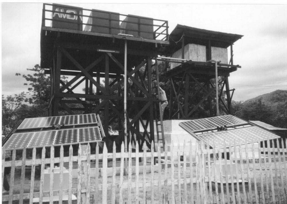
ヤイナンター・ハンセン病院に AMDA (日本の NGO) により設置された揚水用の太陽光パネルと揚水タンク
