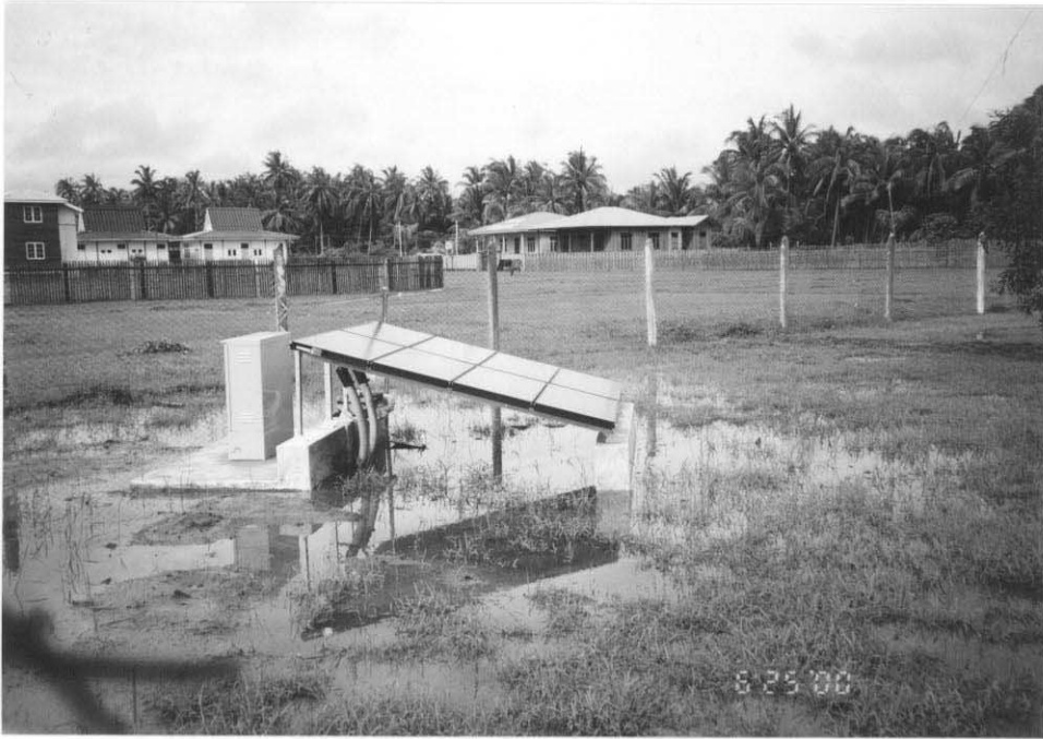
チャンタに NEDO に より設置された太陽 光パネル (500 w)
