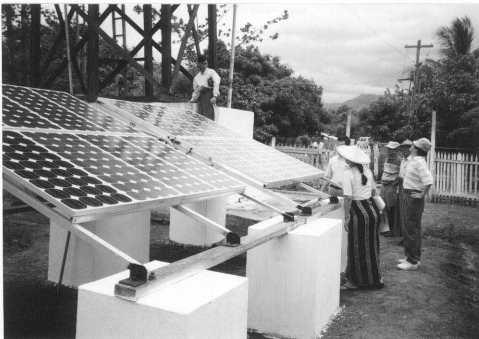
ヤイナンター・ハンセン病院に AMDA (日本の NGO) により設置された揚水用の太陽光パネル
