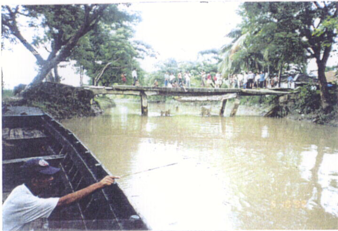
老朽破損したコンクリート橋梁 橋梁番号：13-01-01
