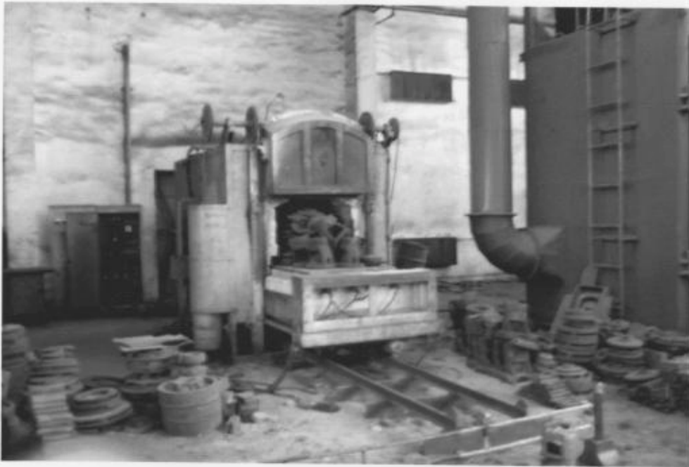
写真 2-2-9 大物部品鋳鋼工場の熱処理炉
