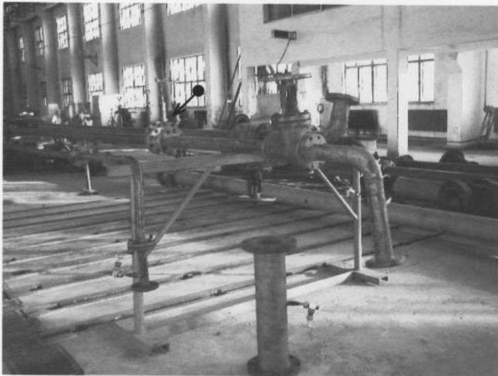
写真 2-6-2 羽根回転式流量計(矢印)取付状況
