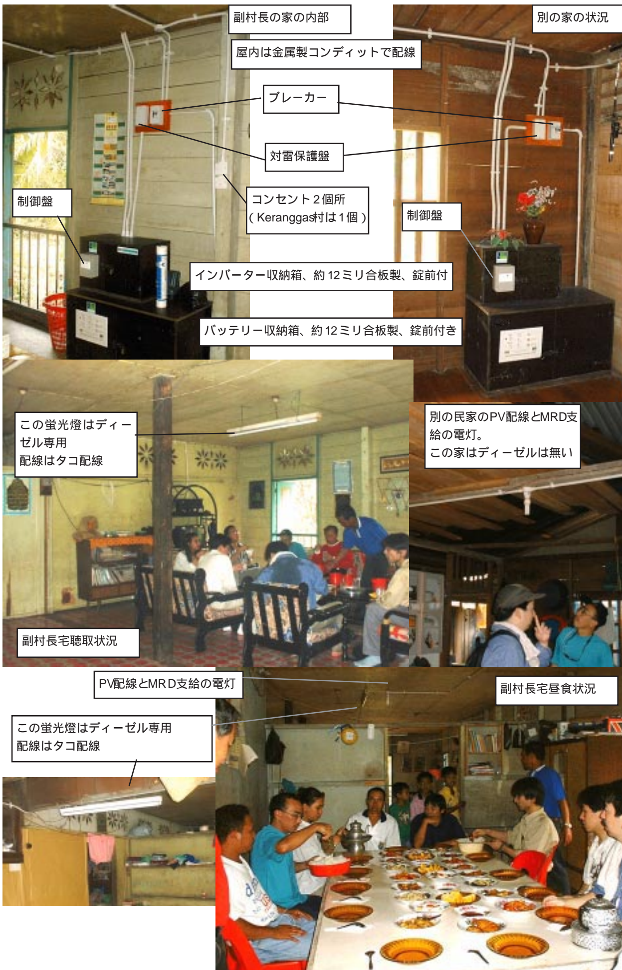
図4-5-3 Apin村家屋内部の設置状況
