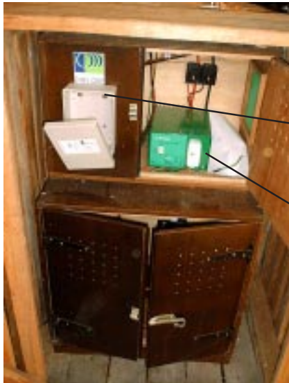
図 4 - 5 - 8 Keranggas村家屋内部の設置状況
