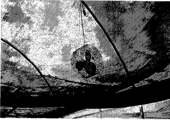
No.65 換気ファン 温室内の気温調節用に5基設置
