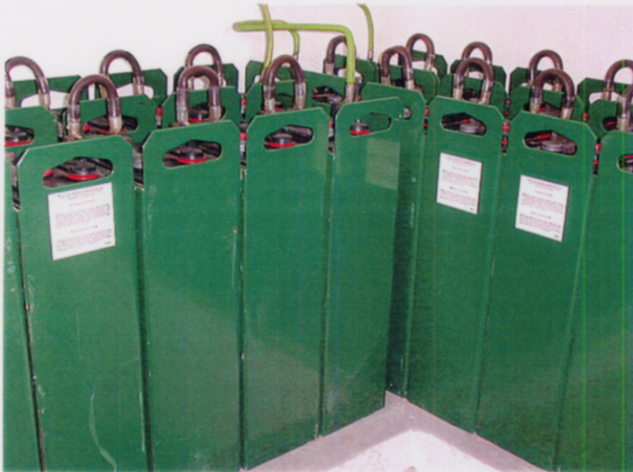
写真8 Motshegaletau PV station project (バッテリー)
