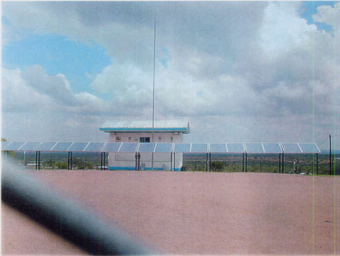
写真7 Motshegaletau PV station project (station全景及びPV パネル)
