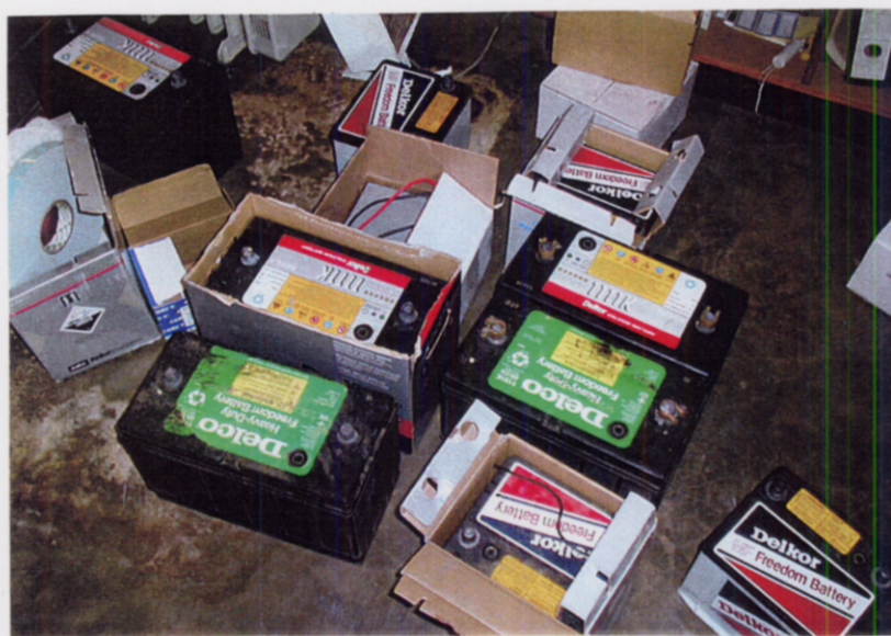
写真5 Madiba Brigades PV 訓練施設 (バッテリー)
