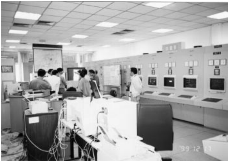
発電所内配電盤室
