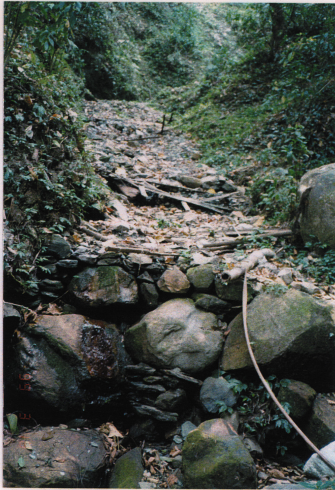
<サブプロジェクト（ガリ防止事業）の視察> 竹組みは壊れたが石積みは残った
