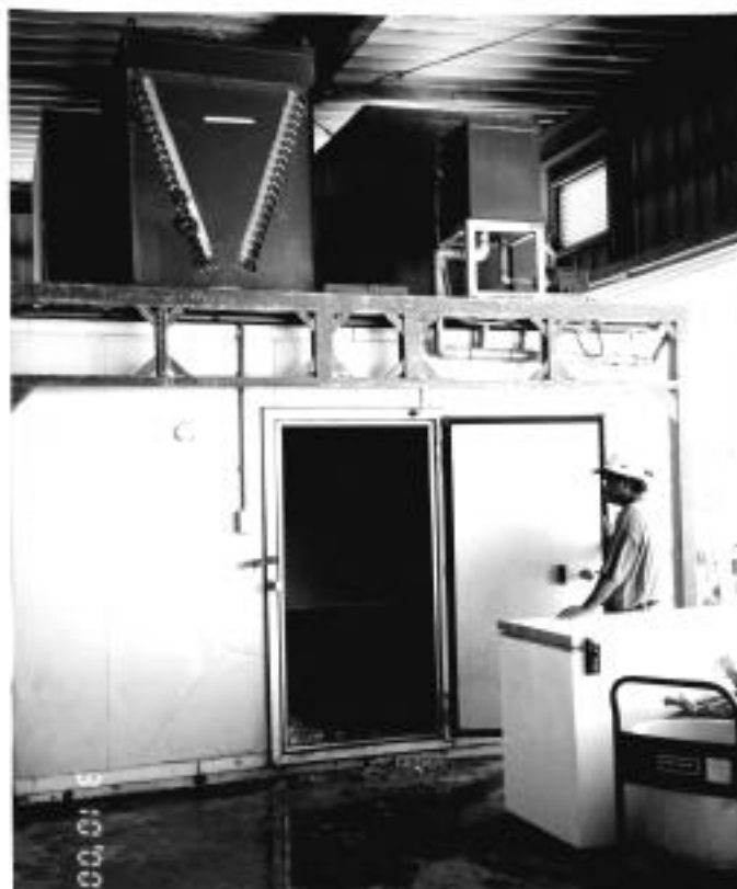
資料写真-30 (同上) マジュロ MIMRA 水揚げ岸壁施設 製氷機・貯水庫
