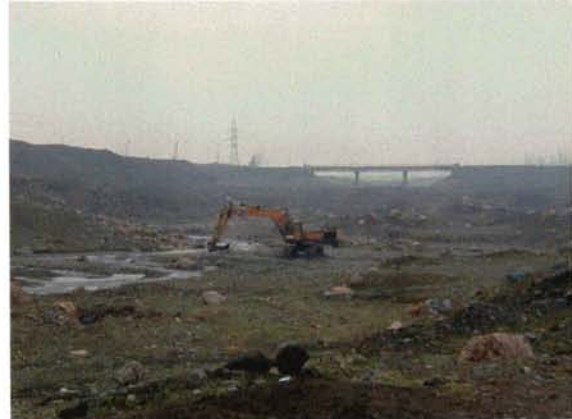
建設事務所の横を流れる川。舗装用骨材である 砂利はここで採取しクラッシングプラントに 運ばれる。砂利採取にはドイツ製掘削機 （1.5m 3 ）が使われている。
