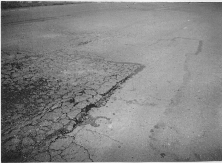
部分補修した後も一部に傷みが 発生している。クタイシ市東方 15km
