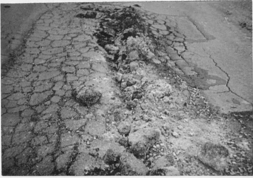
路盤の強化が必要ハシュリ市西方 12km
