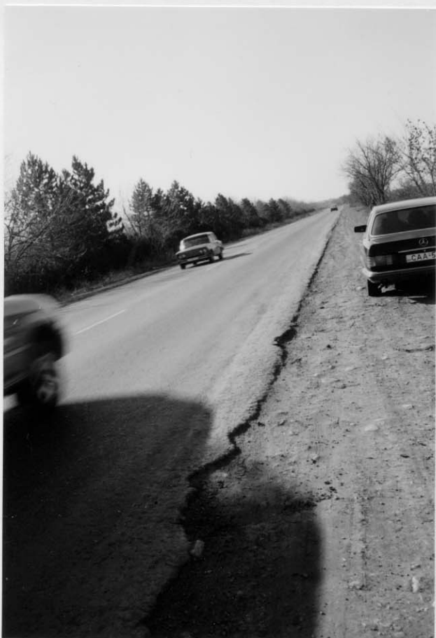
路肩が崩れている、ハシュリ市西方 18km
