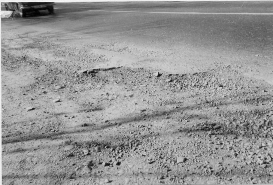
路肩が崩れている、トビリシ市西方 18km
