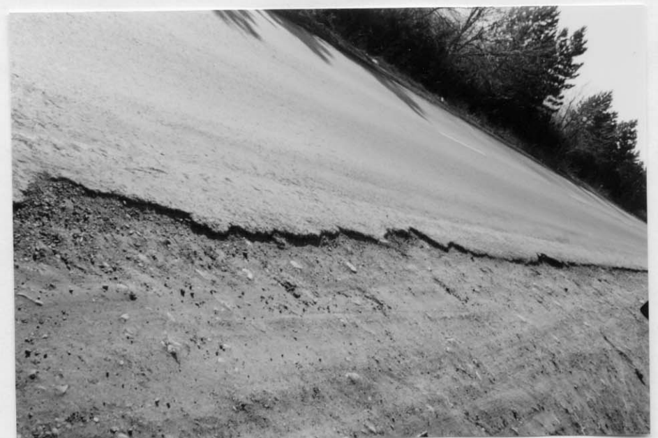
路肩が崩れている、ハシュリ市西方 18km
