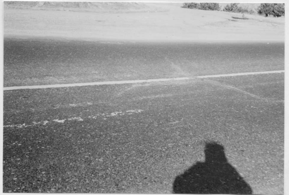
道路の老朽化が進み表層にピンホール が多く入っている。ゴリ市西方 5km
