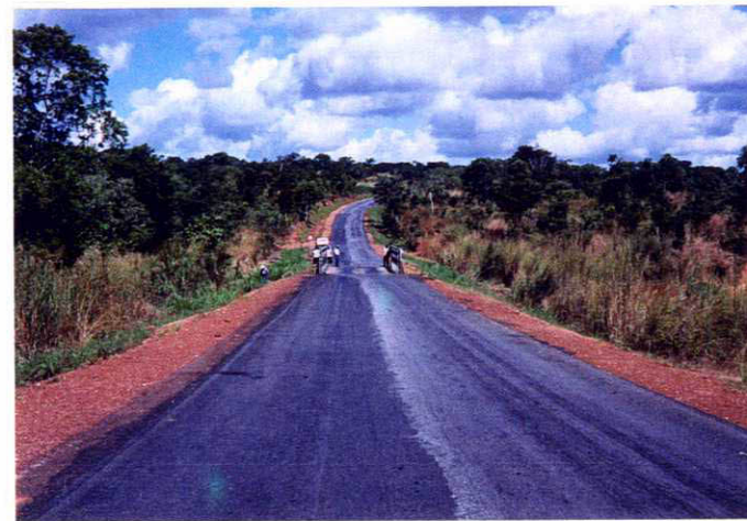
写真-17 国道104号線道路状況 (ナミラテ橋付近)
