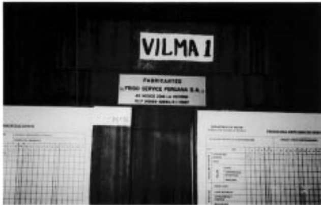
写真27：同県 中央倉庫 ワクチン保管用冷蔵庫 各冷蔵庫には名前が付けられ、温度管理用の記録用紙が貼られている
