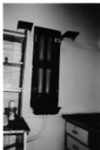
写真52：同研究所 純水製造装置
