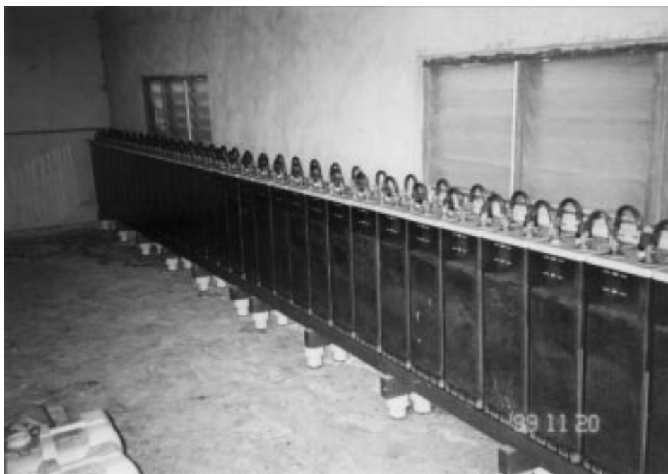
Engkambang村のバッテリー小屋（跡）
