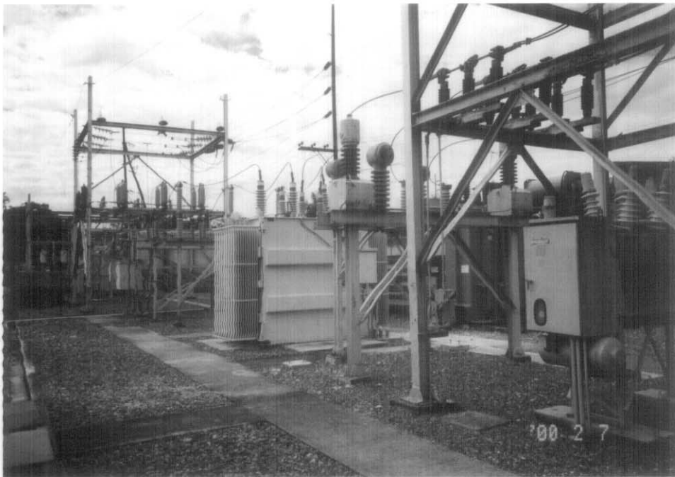
CEPALCO の変電所
