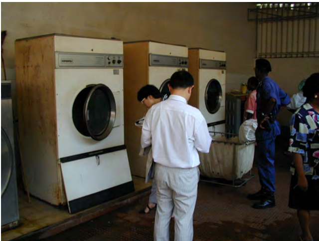
乾燥機（洗濯機・脱水機は故障）
