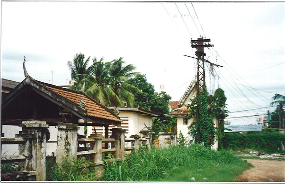
1. CENAT 敷地の中央を横断する変電所からの送電線。架空配線となっているが、世銀の融資を得て一部は地下埋設とされた。しかし、配線が水に浸って危険な状態であり、漏電事故などが懸念される。
