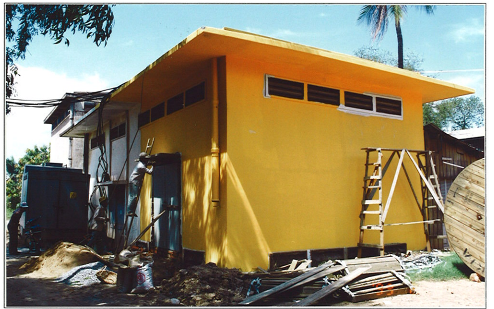
2. CENAT敷地全体の中央に位置する市の変電所。本件敷地内でもあり、先方との協議の結果、工事中及び竣工後の事故発生の危険性を考慮して敷地の南東角に移設されることとなった。
