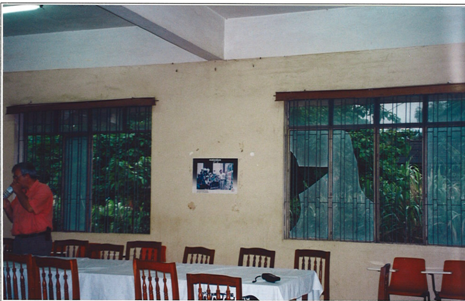
5. 検査棟1階の会議室の状況。CENAT唯一の大会議室（70m 2 ）であり、各種ミーティングに使用される。窓ガラスの破損や床の沈下等、痛みが激しいが、そのまま放置されている。
