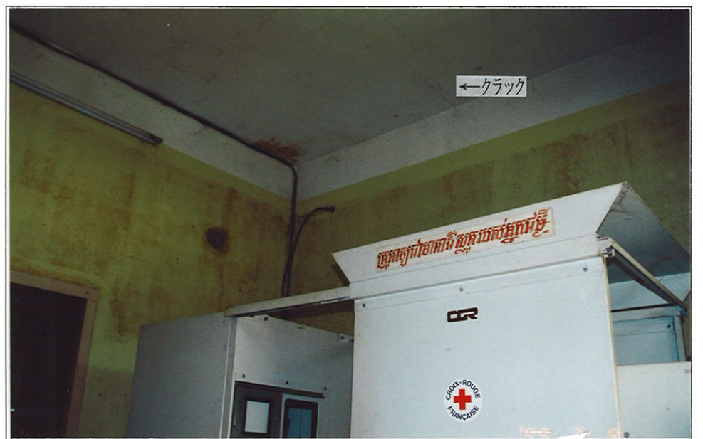
6. 検査棟1階のX線撮影室（奥）の天井の状況。スラブに大きなクラックが生じており、構造的に危険な状態にあると判断された。
