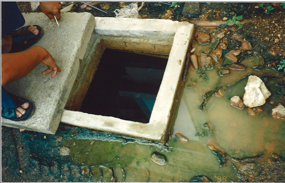
3. 既存検査棟および管理棟用の地下式受水槽。地面と同一レベルにあるため、洪水時には水槽内に汚水が流入し、極めて不衛生な状態となる。これに伴う感染の拡大が懸念される。
