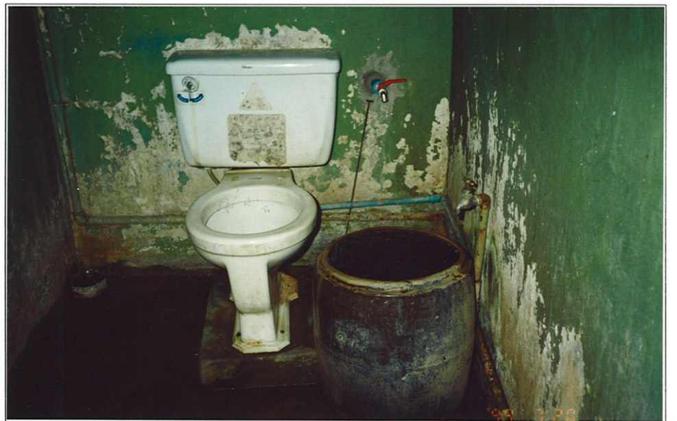
4. 検査棟内部のトイレの状態。施設の老朽化に伴い、トイレの傷みも激しく、ロータンクからの洗浄水も正常に流れない。床の汚染も著しく、極めて不衛生な状態となっている。
