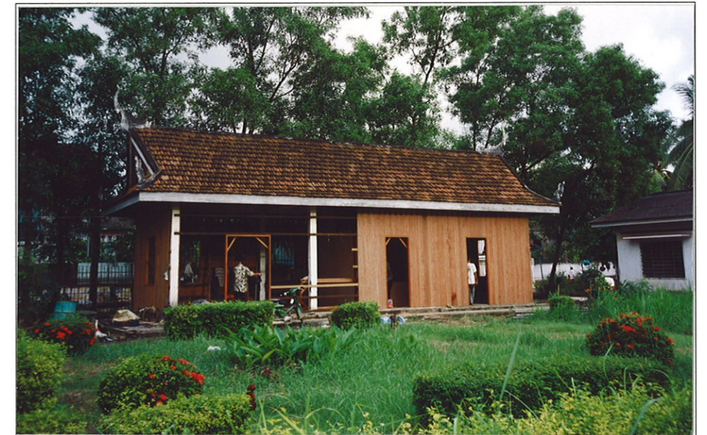
5. 病棟部の仮設事務所工事中の状況。10月末のDF調査時には仮設事務所の工事が開始されていた。吹きさらしの棟に壁を設け、内部を仕切ってDOTS事務所、外来用採痰室として使用する計画となっている。
