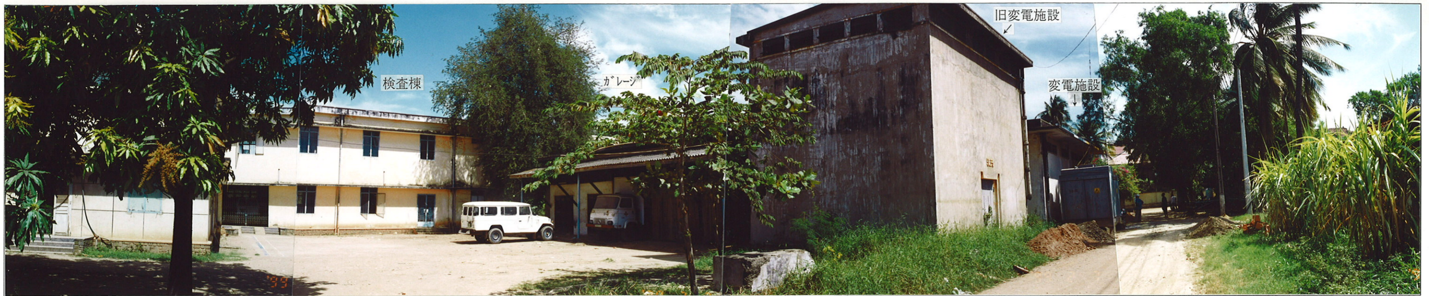
1. CENAT敷地中央に位置する構内道路の西端より敷地北側半分を見る。左端からRC造2階建ての検査棟、ガレージ、旧変電施設、変電施設。構内道路を挟んで右側が病棟エリアとなっている。検査棟は他棟に比べ建物の状態が良く、本件の対象として建て替えるか否か検討を行ったが、躯体までクラックが侵攻しており、使用の継続は危険と判断された。
