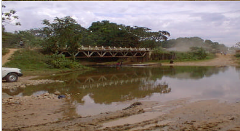
Puente Yapacanicito (km. 48): Puente de cercha con cubierta de madera, largo total 24.5 m., ancho 3.8 m. (vista desde aguas abajo)
