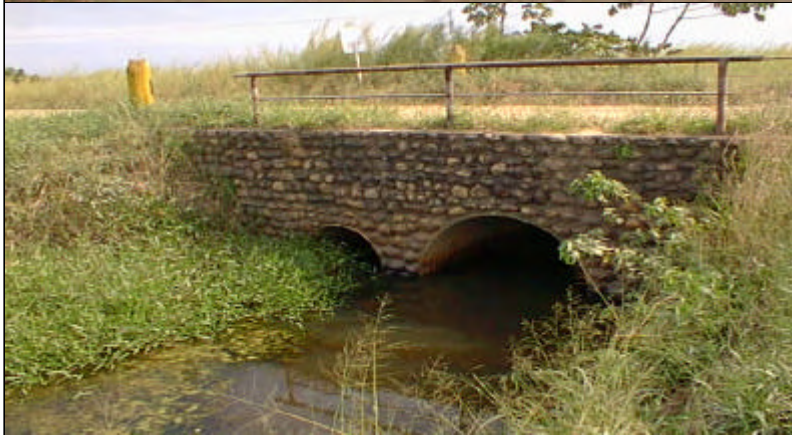
道路横断工 (km36付近): コルゲートパイプ横断排水工 (上流より)
