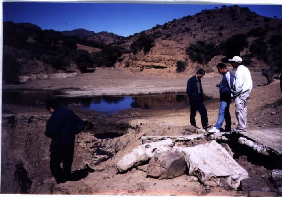
99年2月の豪雨で決壊したアースダム
