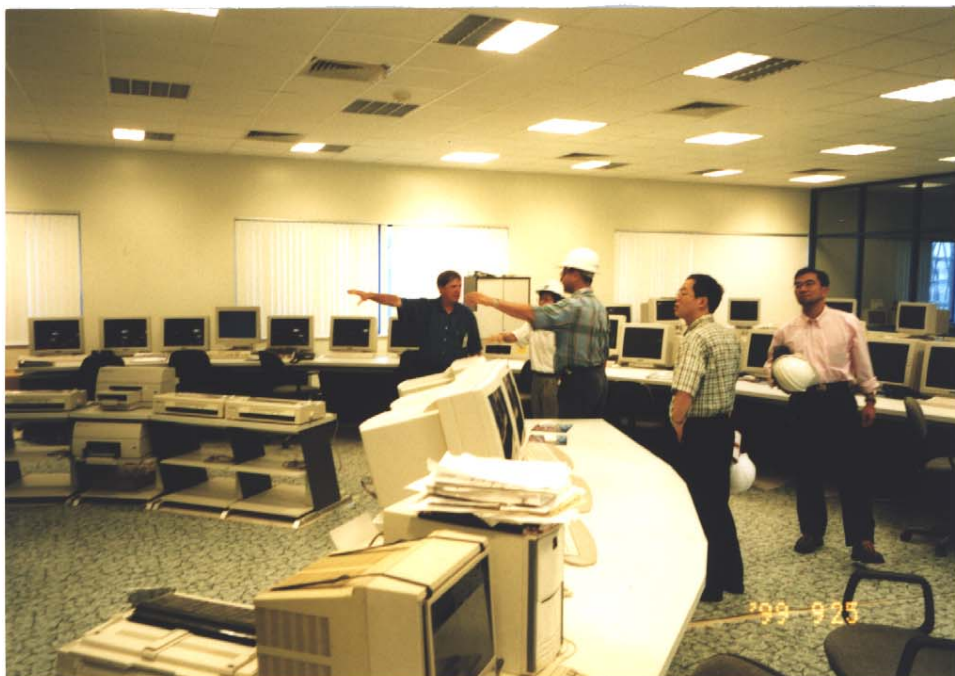
Sta. Rita 発電所コントロールルーム
